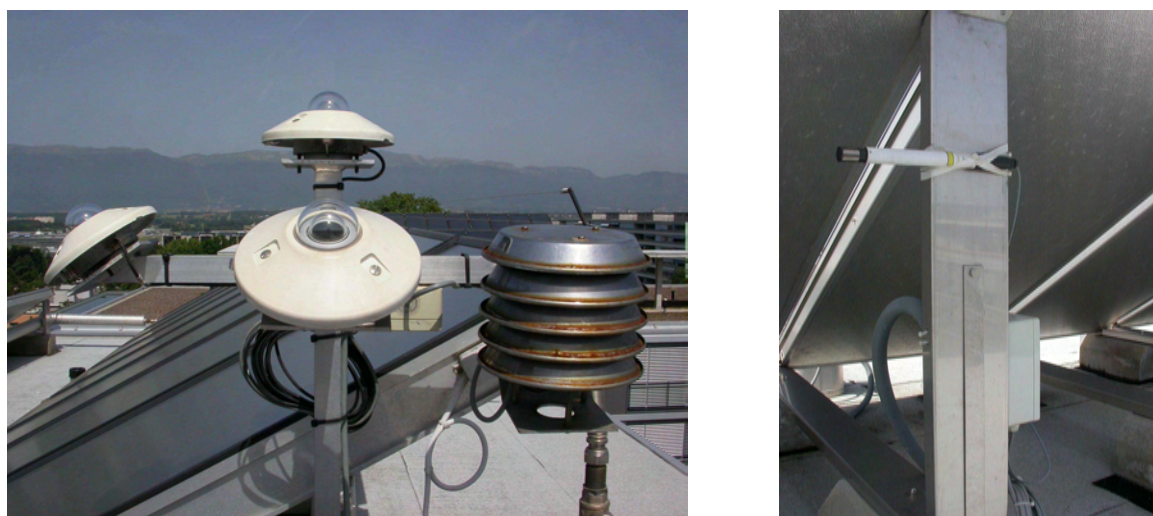
FIG. 1.26 – Gauche : solarimètres pour la mesure de l'ensoleillement global dans le plan horizontal et dans le plan des capteurs Giacometti et Jura/Salève. Également mesure de la température extérieure à l'aide d'une sonde abritée et ventilée. Droite : hygromètre abrité sous les capteurs.
