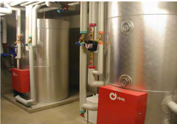
Bouilleurs ECS (gauche) et solaire (droite)
