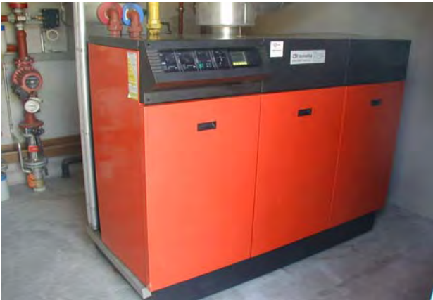
Chaudière en toiture
