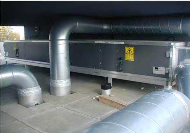
Extraction d'air en toiture
