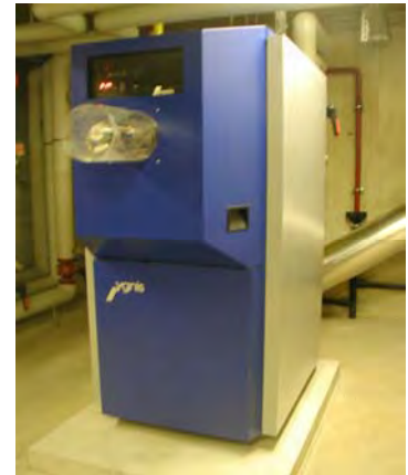
Chaudière à gaz 200 kW
