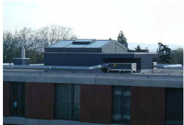
Extraction d'air en toiture
