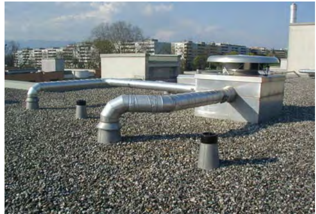
Extraction d'air en toiture
