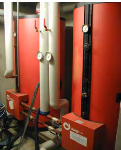
Bouilleurs ECS au sous-sol
