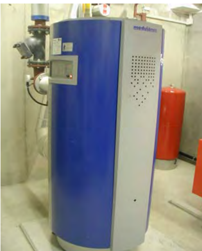
Chaudière à gaz 220 kW
