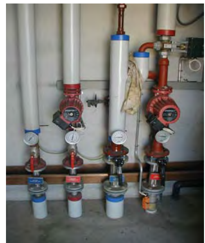
Départ chaleur en toiture
