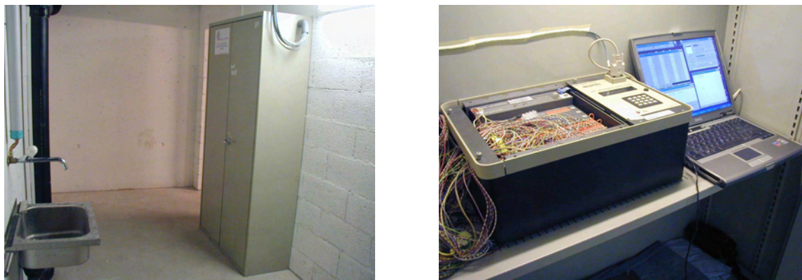
FIG. 1.21 – Armoire (gauche) contenant le datalogger de mesure (droite).
